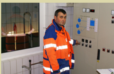
Wasserwart Johann Ortner im Hochbehälter
