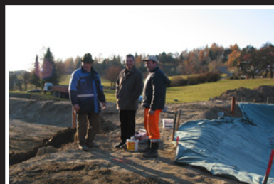
Ein großes Projekt war der Bau von Reinigungsbecken sowie die Errichtung von zwei Tiefenbohrungen zur Einspeisung für den Badesee.
