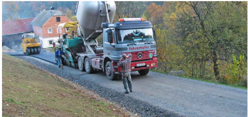
Das Land OÖ leistet hohe finanzielle Beiträge zur Aufrechterhaltung eines intakten Güterwegenetzes.
